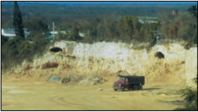
Foto 64. Maquinaria operando cerca de la carretera PR 22, km 39.2, destruye dos cavidades. Foto de L. Miranda Castro.
