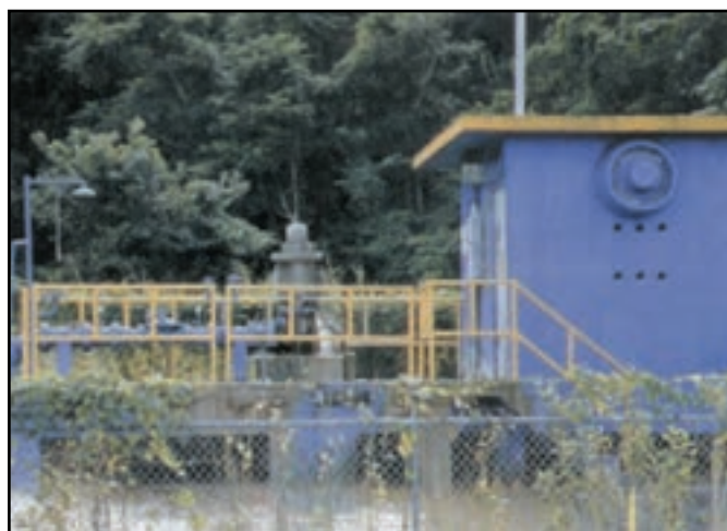
Foto 51. Bombas de agua subterránea de la Compañía de Aguas de Puerto Rico en Dorado, Puerto Rico. Foto de L. Miranda Castro.
